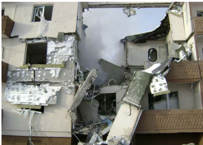
Рисунок – 1. Общий вид повреждений строительных конструкций при взрыве бытового газа в жилом здании
