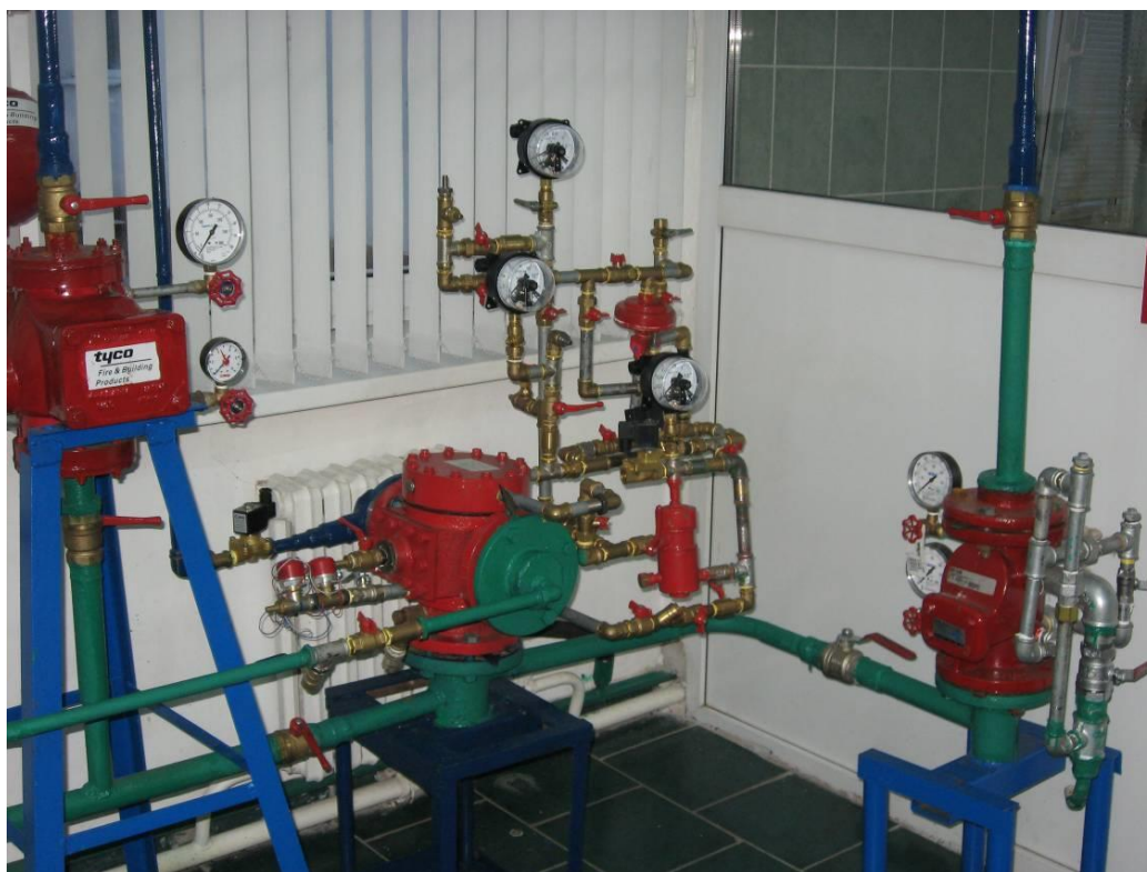
Рисунок – 2. Внешний вид узла управления экспериментальной установки автоматического водяного пожаротушения
