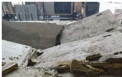
Рисунок –5. Фото разрушения железобетонных плит
