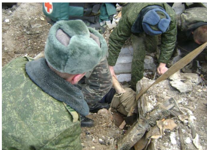
Рисунок – 3. Закрепление спасателями поврежденного негабаритного железобетонного изделия не стандартной формы с помощью подручных средств
