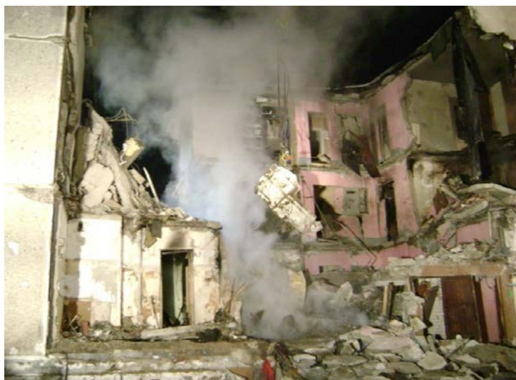
Рисунок – 2. Аварийное состояние здания, грозящее обрушением строительных конструкций
