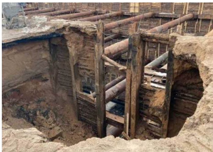
б – вывал грунта при креплении борта котлована
