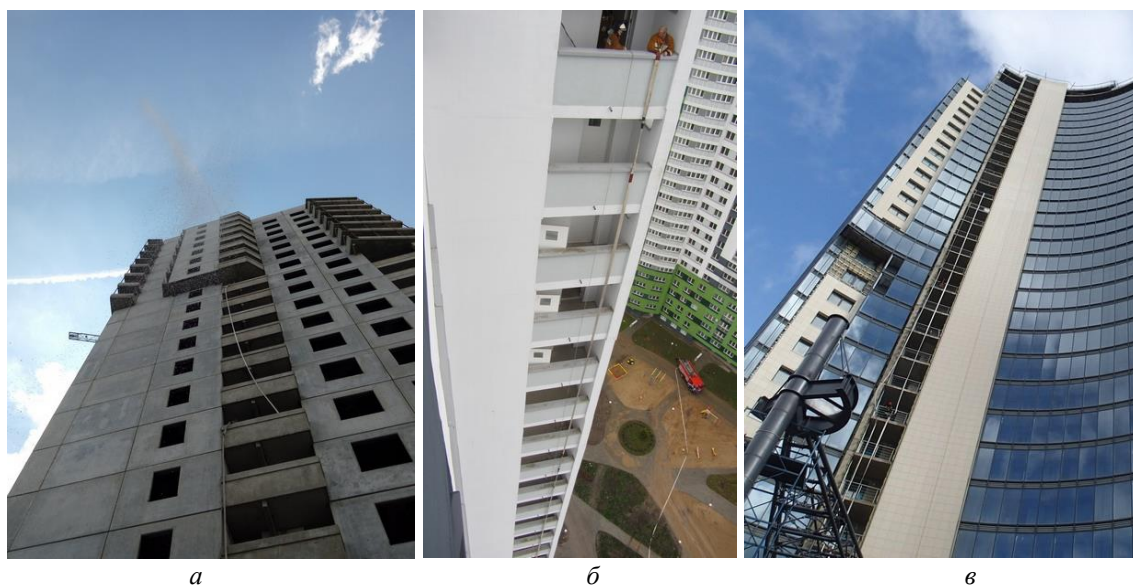
Рисунок 3 – Натурные испытания подачи компрессионной пены на высоту а – 18 этаж (50 м), б – 25 этаж (75 м), в – 32 этаж (100 м)
