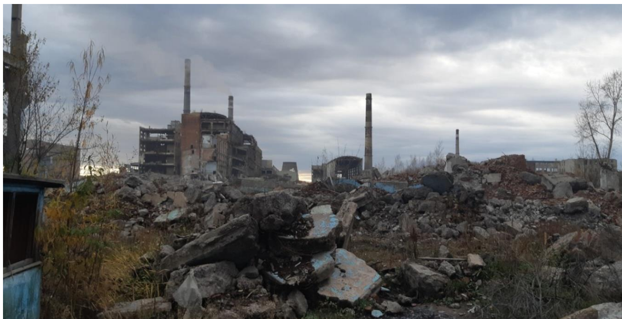
Рисунок 1. – Вид разрушенных корпусов ЦКК (октябрь 2022 г.)
