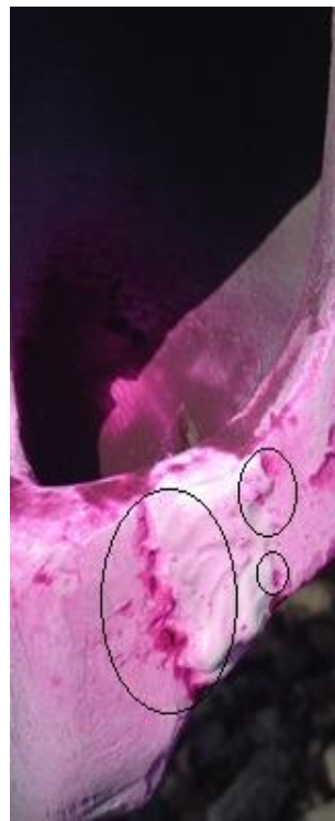
б – следы на границе сплавления сварного шва
