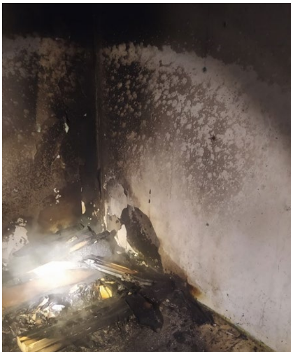
а – термические повреждения ГКЛВ (на фото справа)
