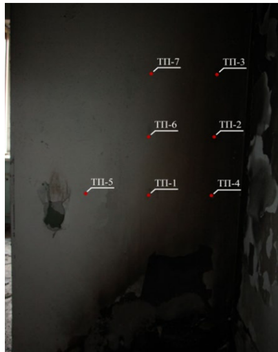
б – внешний вид конструкций после тушения модельного очага пожара
