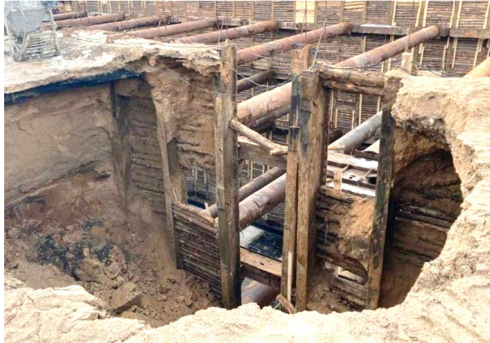
б – вывал грунта при креплении борта котлована
