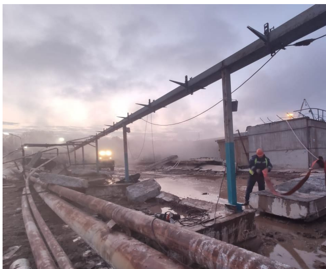
Рисунок 2. – Последствия разрушения резервуара со стоками производства
