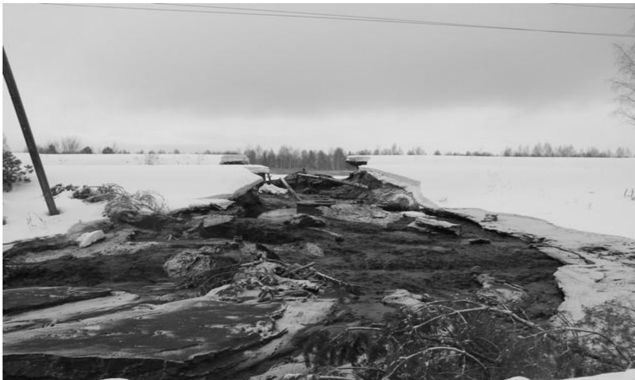
Рисунок 1 – Прорыв обвалования карты поля фильтрации городских очистных сооружений Круглянского УКП «Жилкомхоз»
