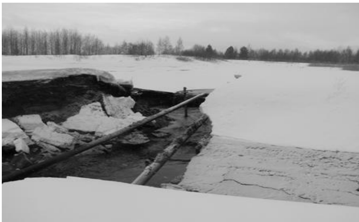
Рисунок 2 – Прорыв обвалования карты поля фильтрации городских очистных сооружений Круглянского УКП «Жилкомхоз»
