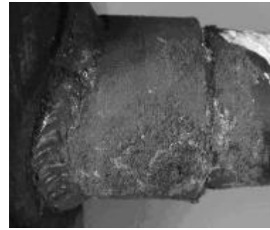
Коррозия напорного патрубка
