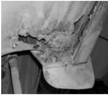
Коррозия элемента ходовой части
