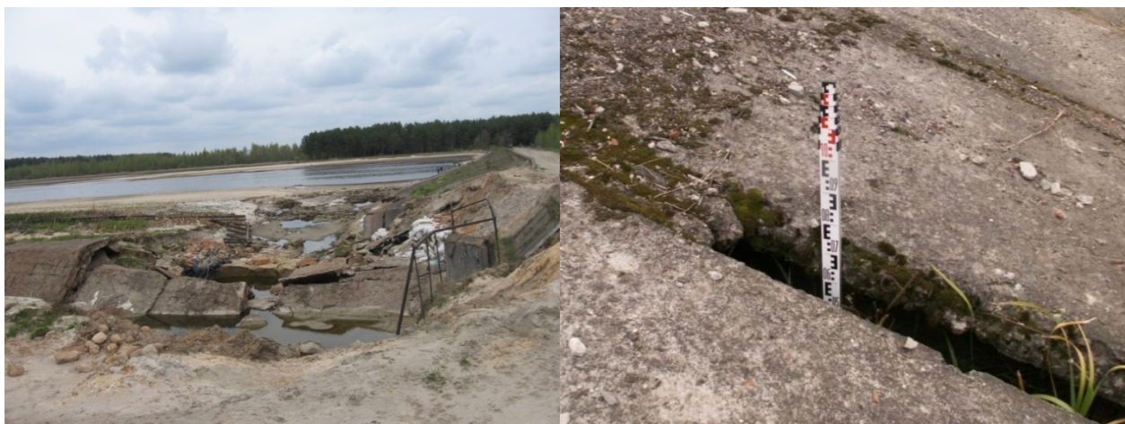
а) общий вид разрушенного гидроузла
