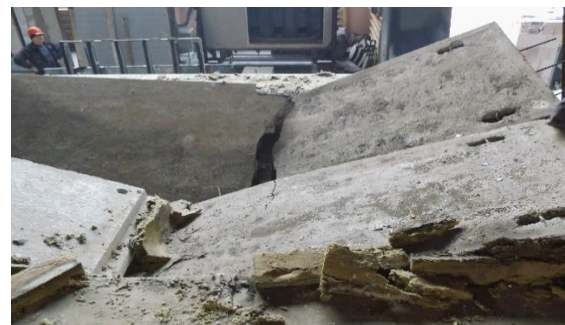
Рисунок 4 – Фото разрушения железобетонных плит
